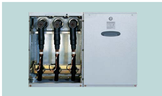
Kábelcsatlakozás az -1LSV630- típusú, átvezető-áramváltóval ellátott megszakítós leágazómezőben. A bal oldali mező ajtaja nyitva van.
