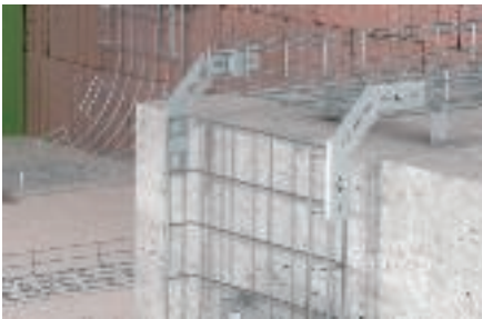
Készre szerelt C-profilú rácsos kábeltálca nyomvonalon.
