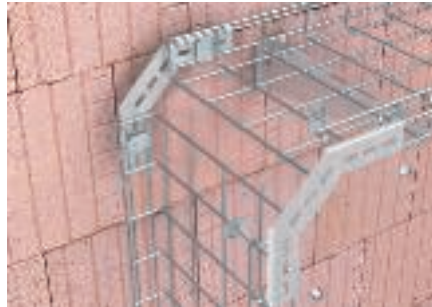
A C-profilú rácsos kábeltálcából kialakított nyomvonal 90°-os vertikális iránytörésének kialakítása MW 90 SL típusú szerelőszeglettel. Az alátámasztást a beépített falikonzol biztosítja.
